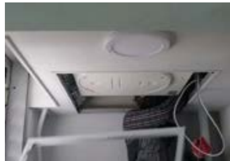
[ 천장 점검구 내 설치 ]
