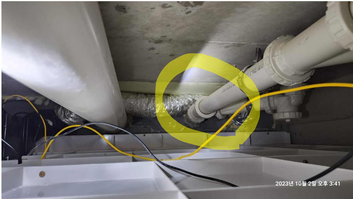
<그림1, 공용욕실 설치분> 주름관이 파이프 사이에 눌러 설치됨 해당 공간의 냄새가 제습, 환기모드 사용시에만 배기구를 통해 내려옴
