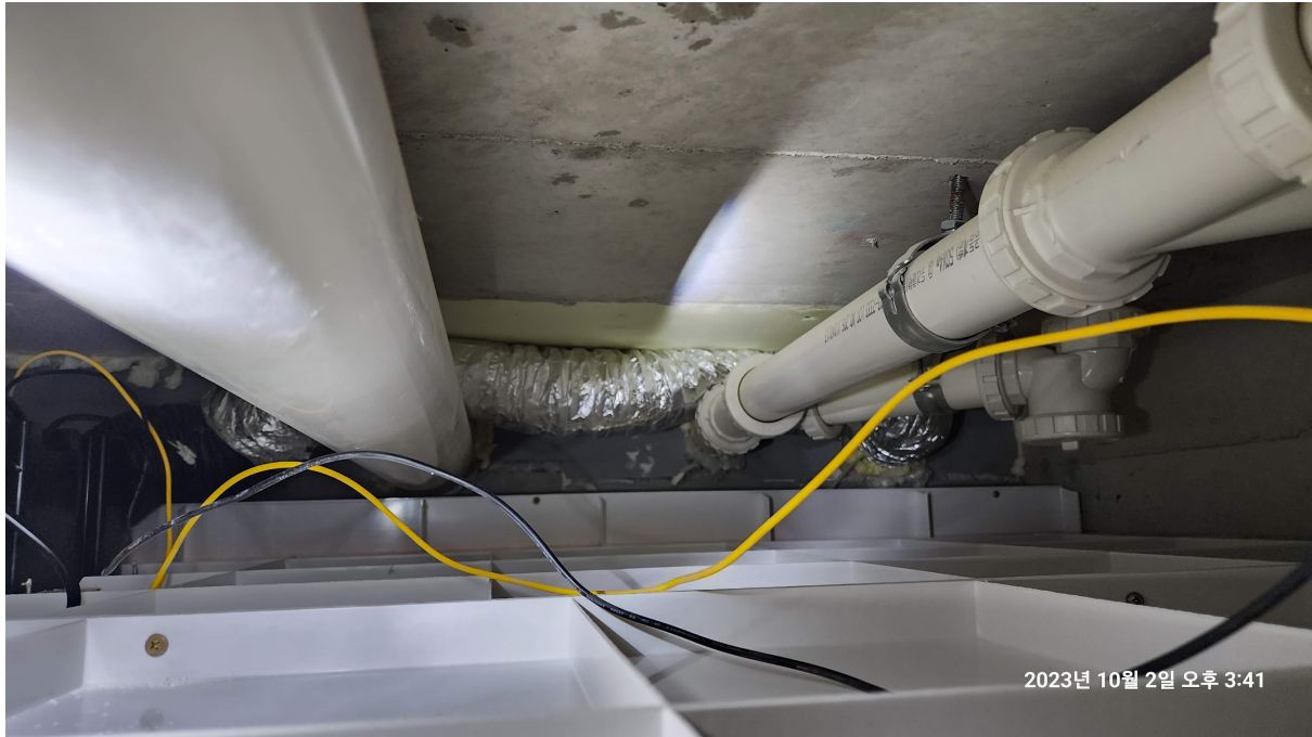
<그림1, 공용욕실 설치분> 주름관이 파이프 사이에 눌러 설치됨 해당 공간의 냄새가 제습, 환기모드 사용시에만 배기구를 통해 내려옴
